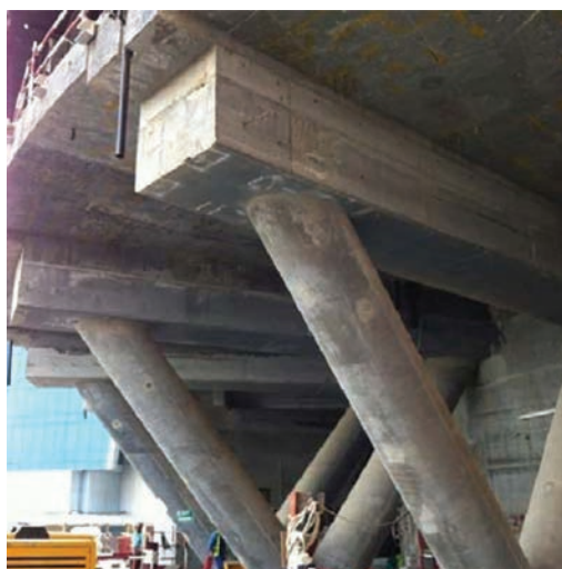
Fig. 5. V-shaped columns of Regent Pearl Hotel located in U.A.E. [16] 5. ábra V-alakú pillérek a Regent Pearl Hotel tartószerkezetében [16]
